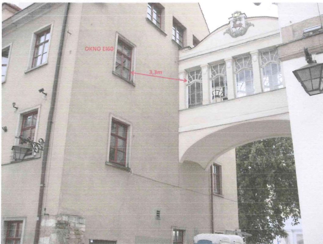
Fot. 9. Okna w ścianie szczytowej kamienicy z lewej strony łącznika do wymiany na przeciwpożarowe w klasie EI 60
