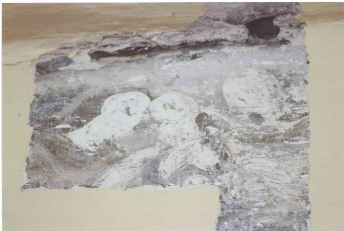
FOT. 15 - Pomieszczenie 1/06, detal fot. 14.
