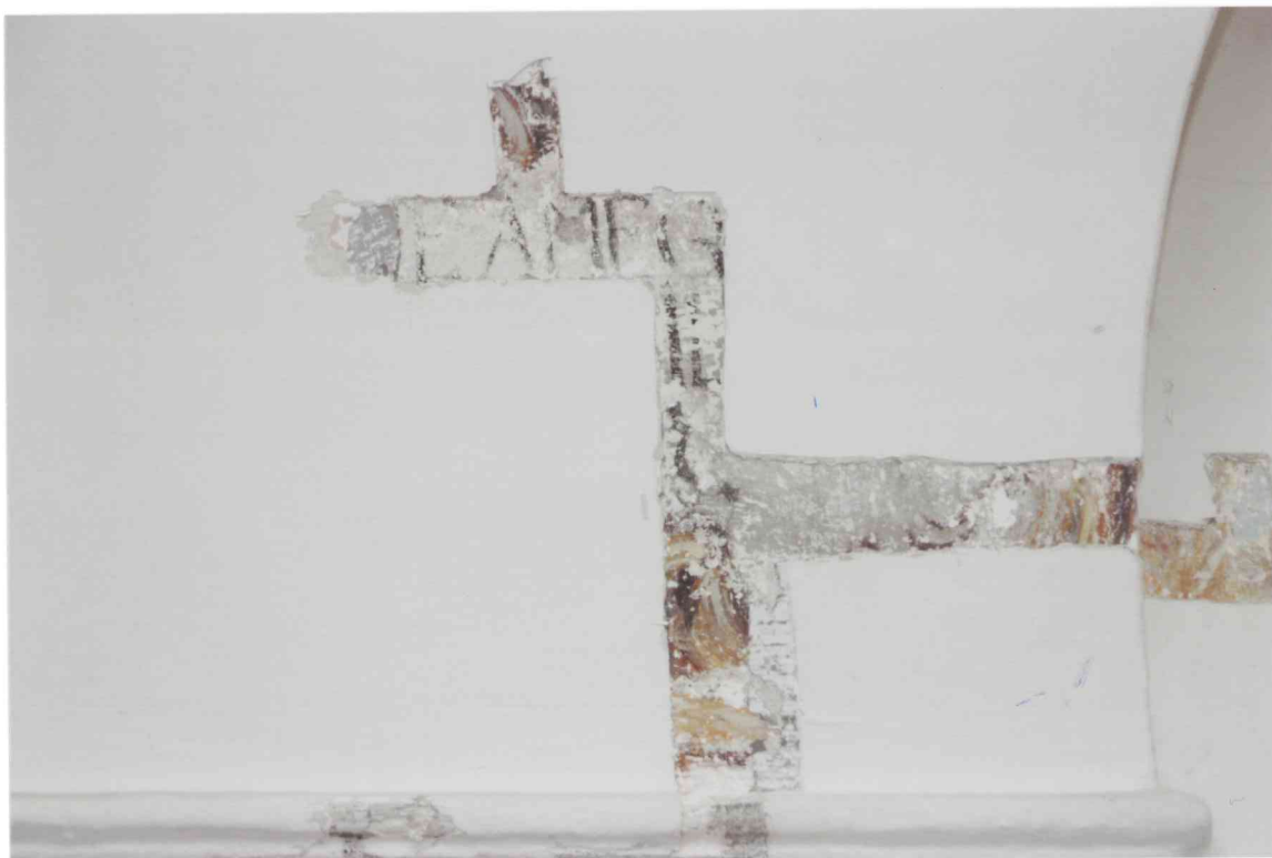
FOT. 6 - Pomieszczenie 1/03, detal fot. 5.
