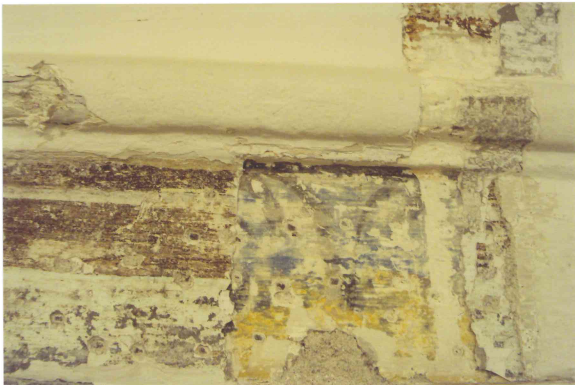
FOT. 8 - Pomieszczenie 1/03, detal fot. 5.
