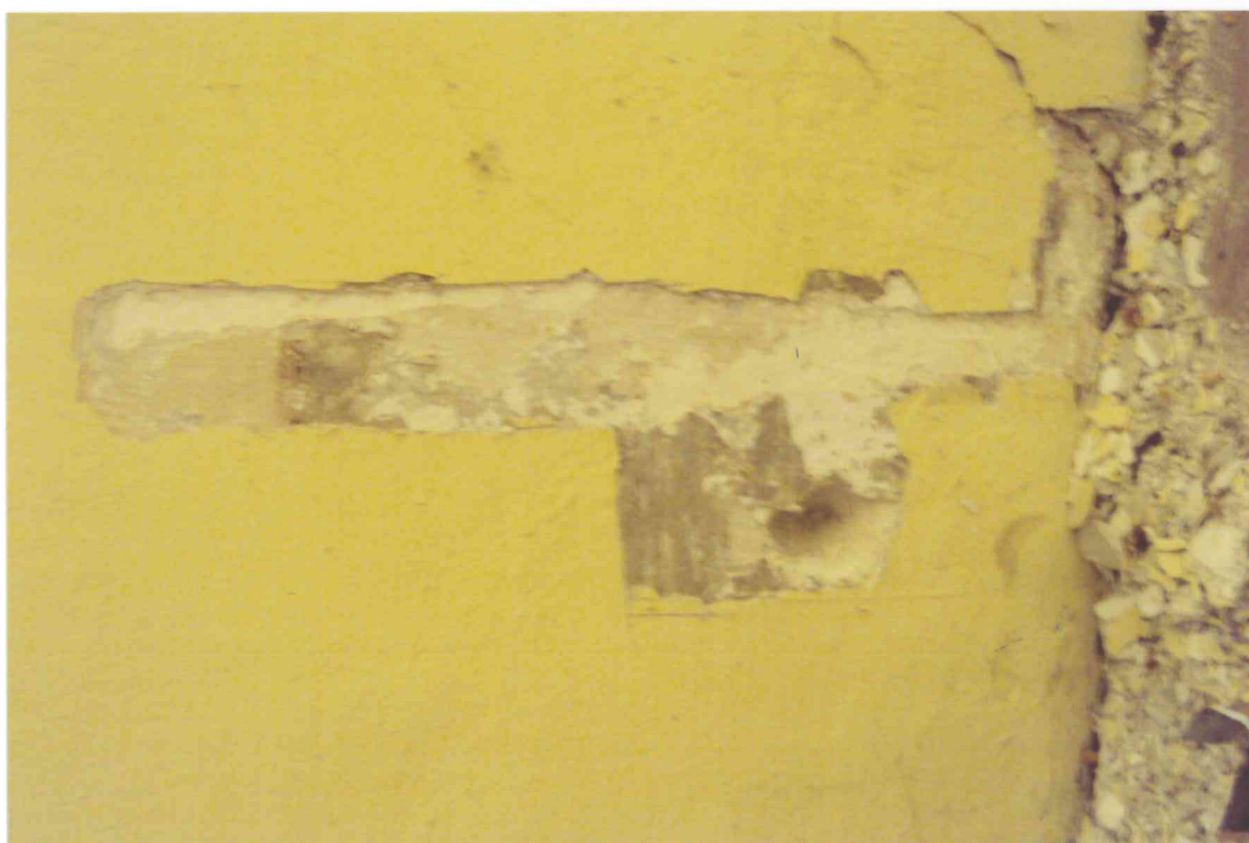
FOT. 4 - Pomieszczenie 1/04, ściana północna, cokół, detal fot.1.
