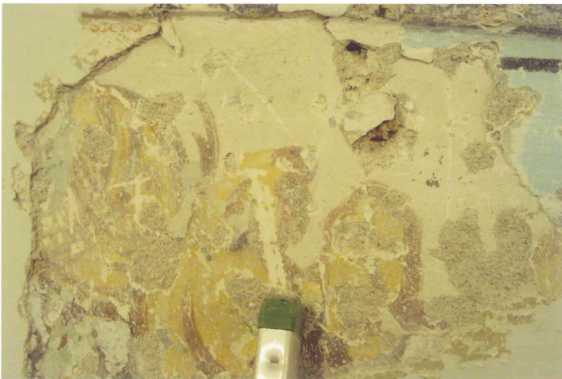
FOT. 9 - Pomieszczenie 1/03, detal fot. 5.
