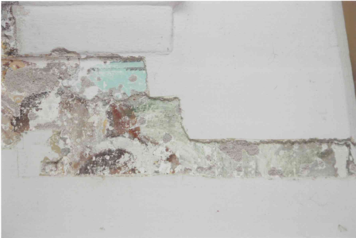
FOT. 7 - Pomieszczenie 1/03,, detal fot. 5.
