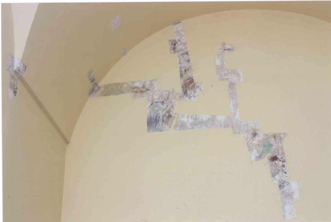
FOT. 8 - Pomieszczenie 1/06, detal fot. 9.
