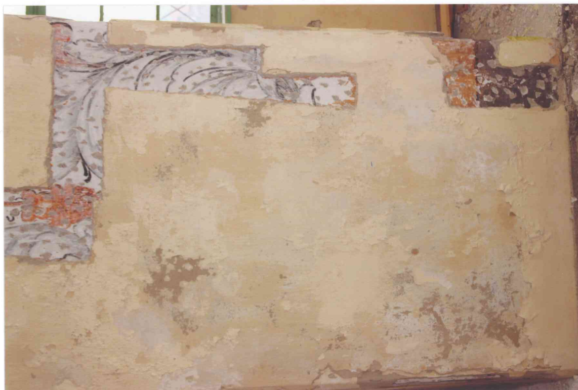
FOT. 8 - Pomieszczenie 1/07, detal fot. 5.
