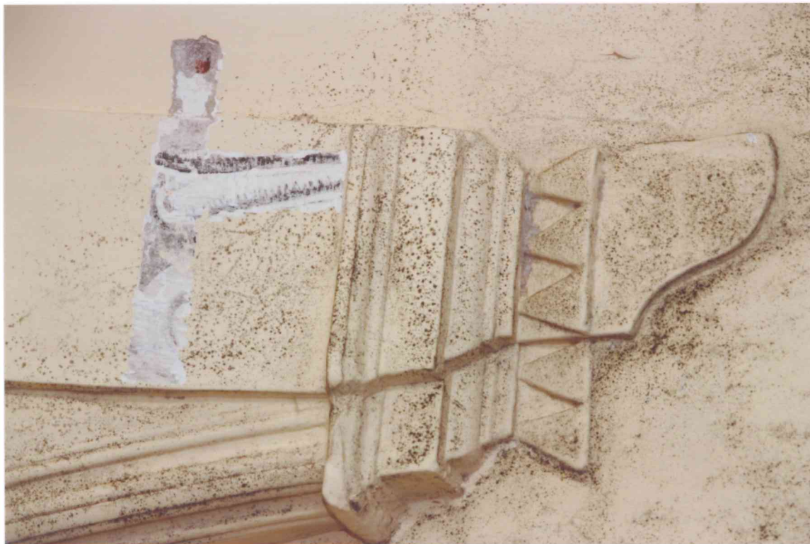
FOT. 12 - Pomieszczenie 1/07, ściana północna, spływ sklepienia, detal fot. 1.
