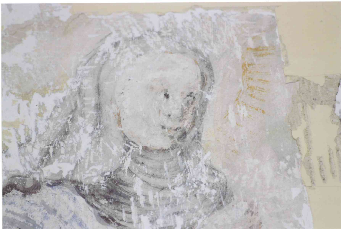
FOT. 19- Pomieszczenie 1/06, detal fot. 18.
