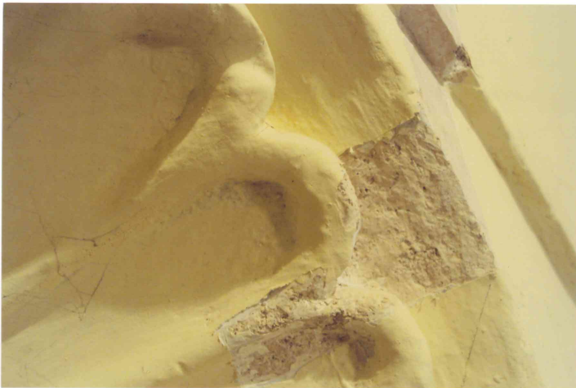
FOT. 7 - Pomieszczenie 1/05, detal fot. 5.
