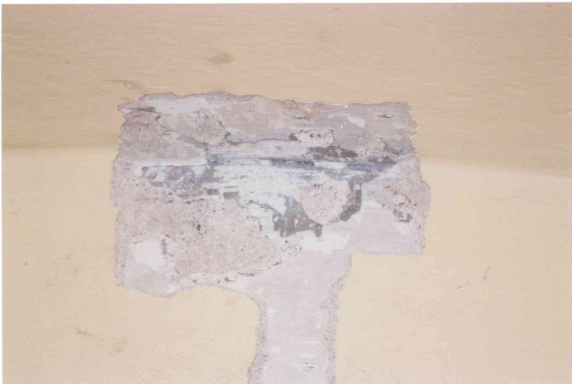
FOT. 10 - Pomieszczenie 1/06, detal fot. 9.
