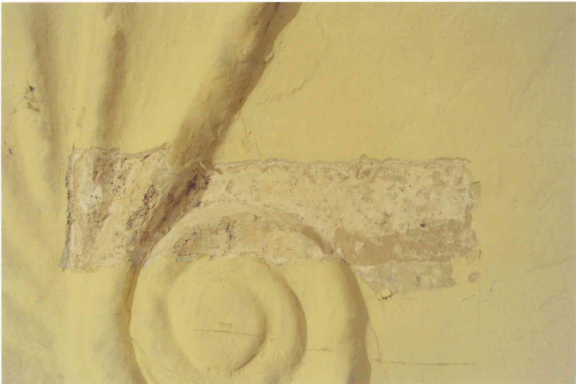
FOT. 6 - Pomieszczenie 1/05, detal fot. 5.
