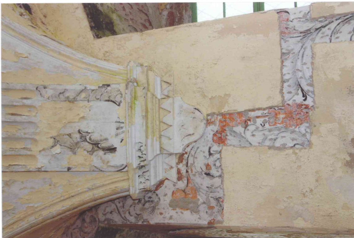
FOT. 7 - Pomieszczenie 1/07, detal fot. 5.
