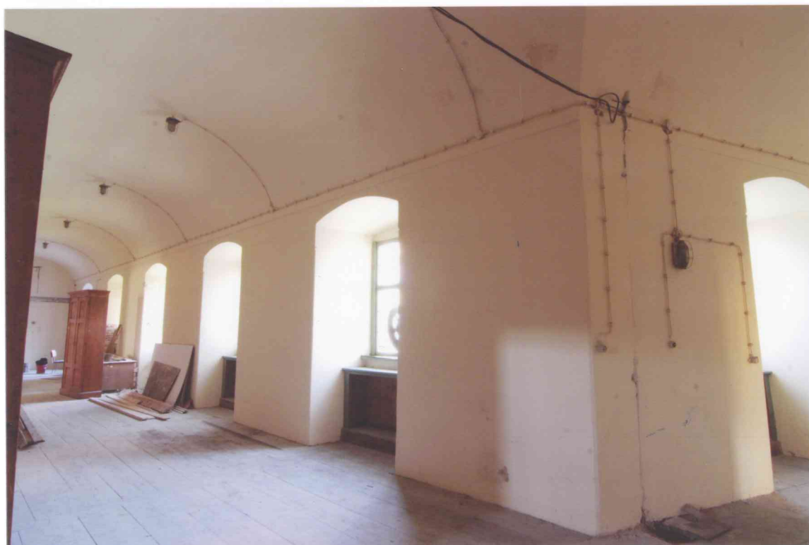
FOT. 2 - Korytarz 1/K, część zachodnia, narożnik północno-zachodni, widok w stronę wschodnią na ścianę południową.
