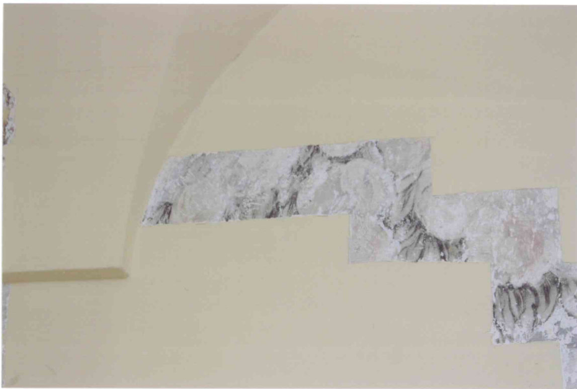
FOT. 23 - Pomieszczenie 1/06, detal fot. 6.
