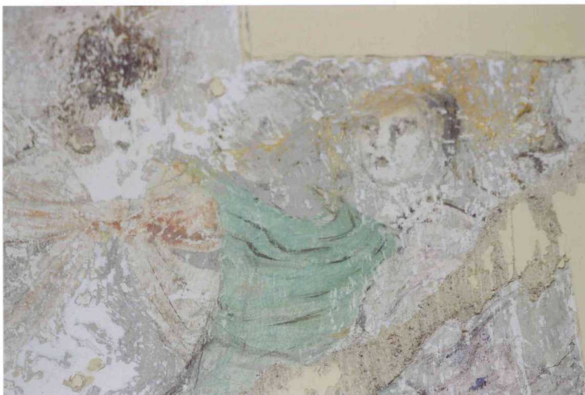
FOT. 20 - Pomieszczenie 1/06, detal fot. 8.
