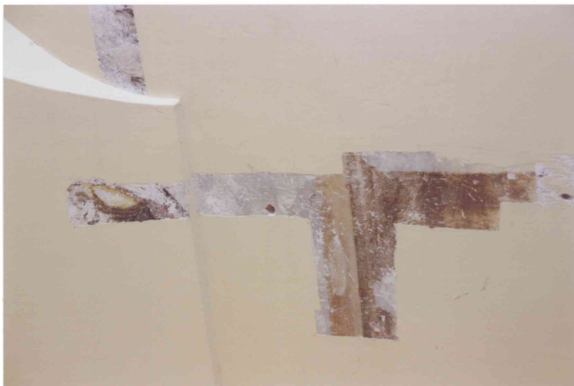
FOT. 24 - Pomieszczenie 1/06, detal fot. 6.
