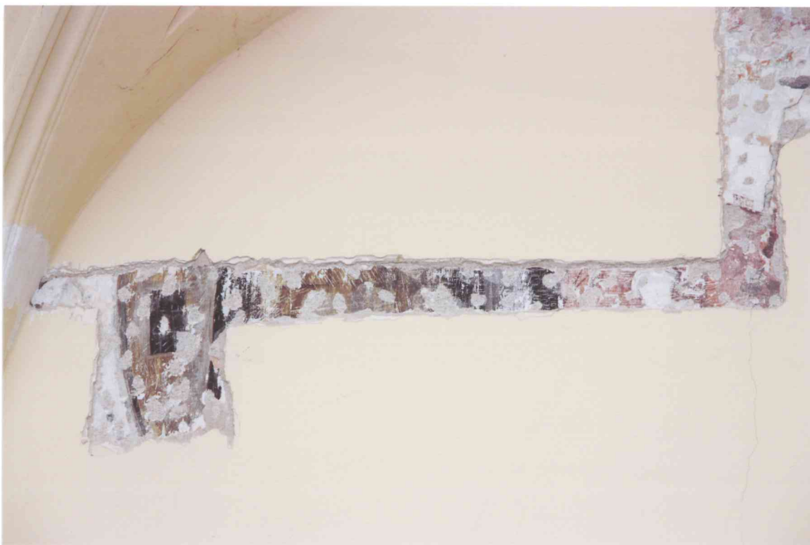
FOT. 15 - Pomieszczenie 1/07, detal fot. 14.
