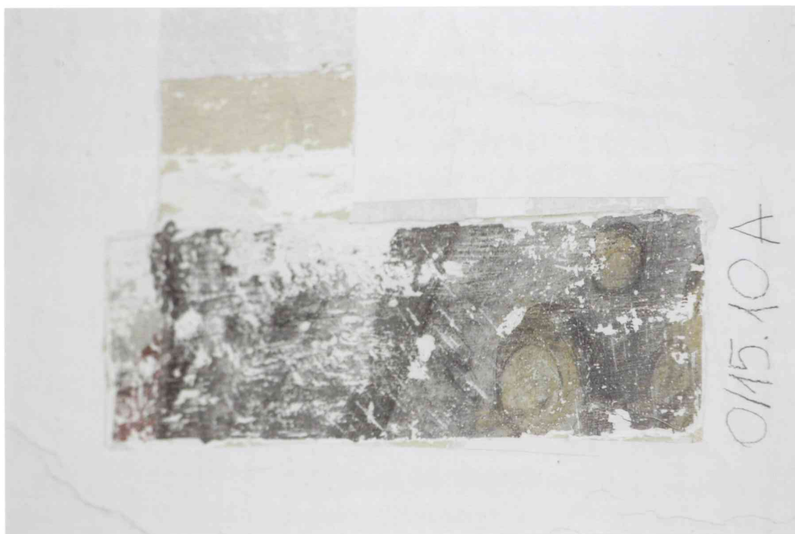
FOT. 19 - Pomieszczenie 0/15, ściana północna, detal fot. 5.
