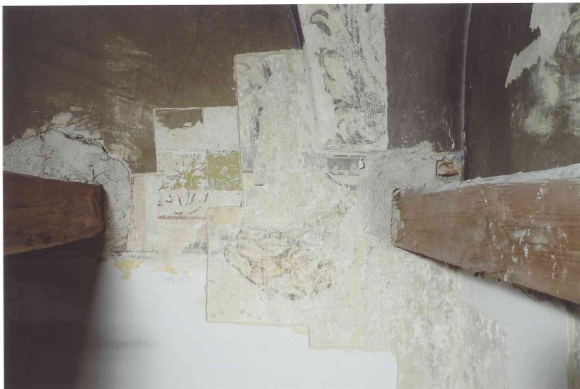
FOT. 7 - Pomieszczenie 0/13, ściana wschodnia, detal fot. 3.
