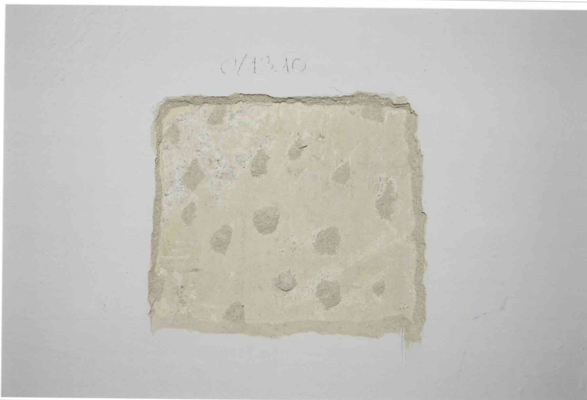
FOT. 12 - Pomieszczenie 0/13, ściana wschodnia, detal fot. 3.
