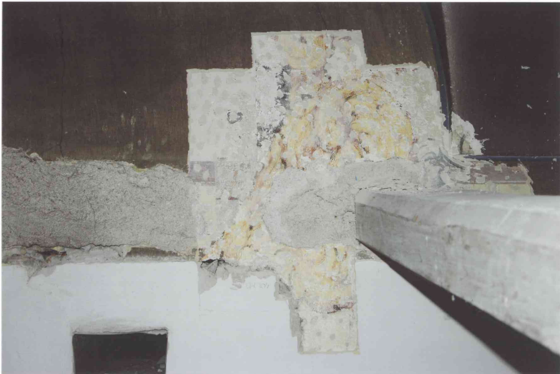
FOT. 4 - Pomieszczenie 0/13, ściana wschodnia, detal fot.3.
