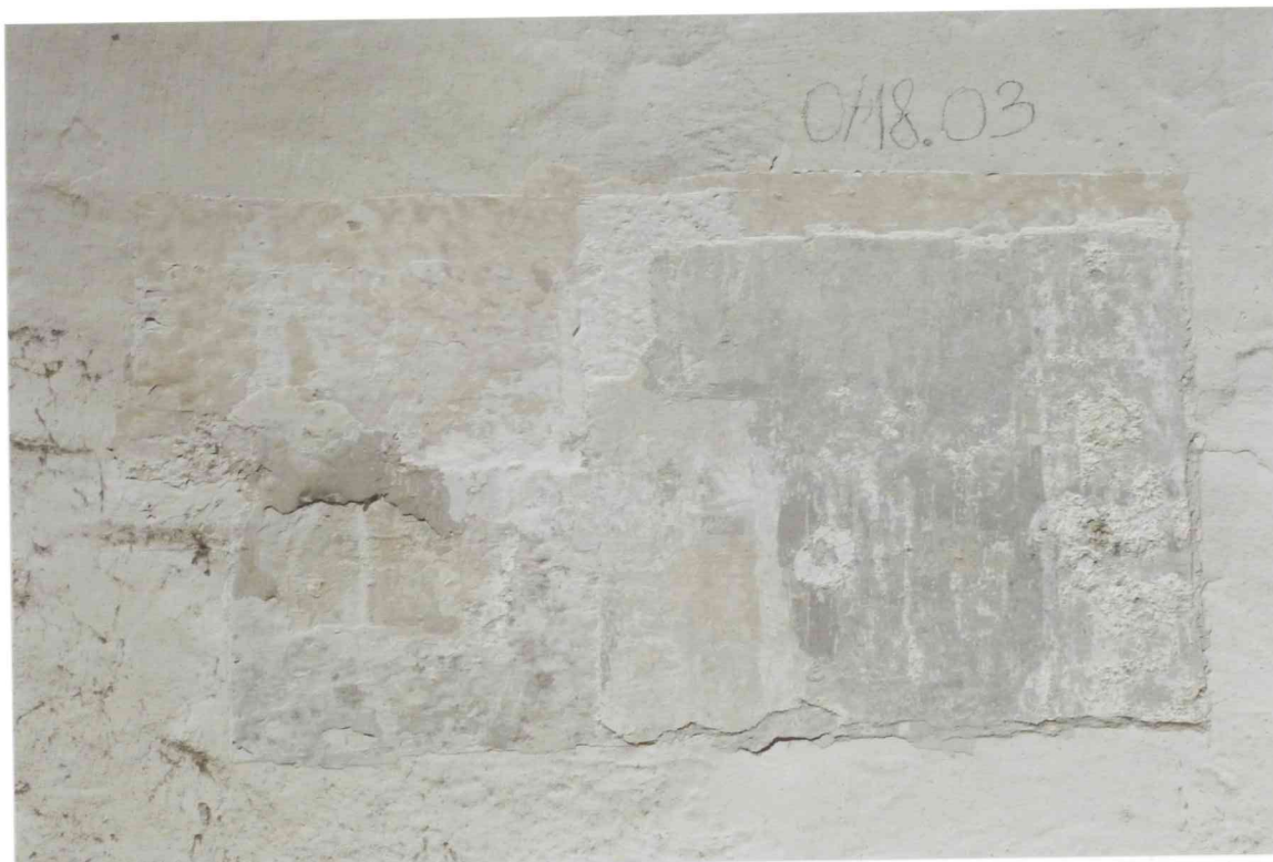
FOT. 5 - Pomieszczenie 0/18-0/19, ściana północna, detal fot. 3.
