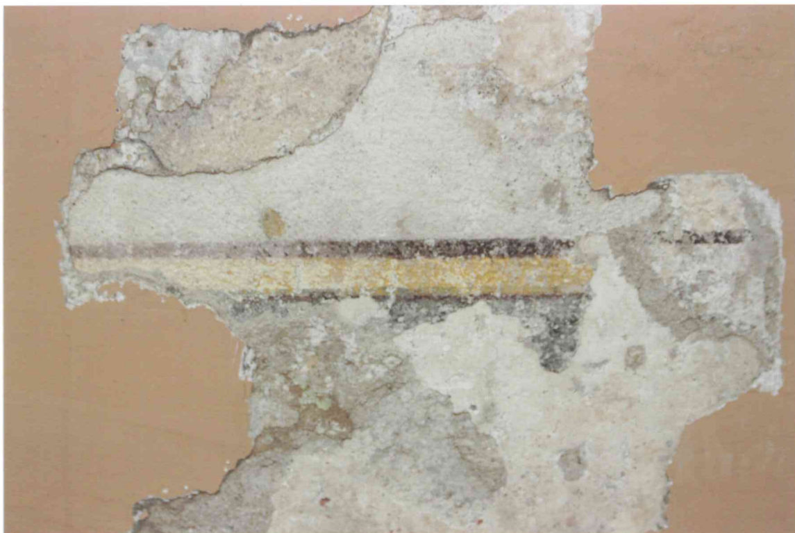
FOT. 7 - Pomieszczenie 0/15, ściana północna, detal fot. 6.
