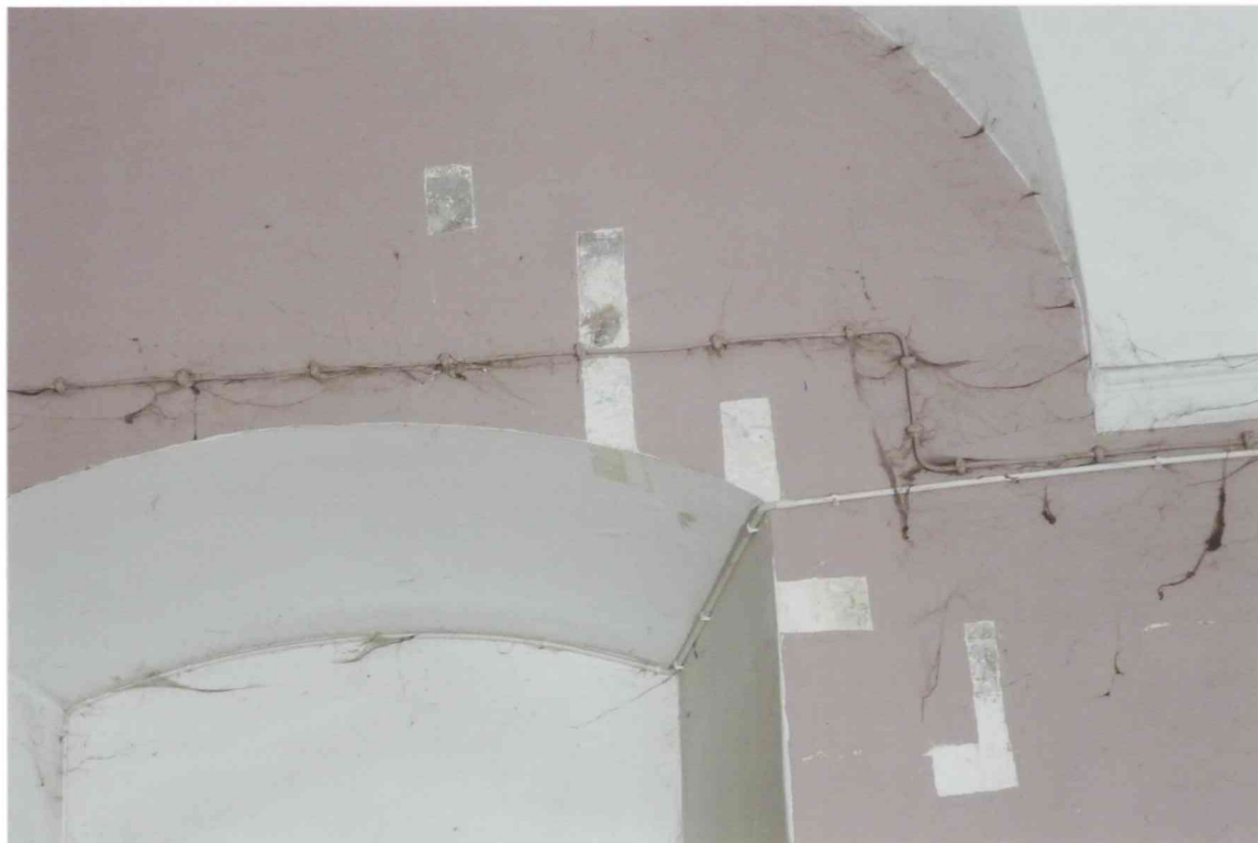
FOT. 6 - Pomieszczenie 0/01-0/K2, ściana wschodnia, detal fot. 1.
