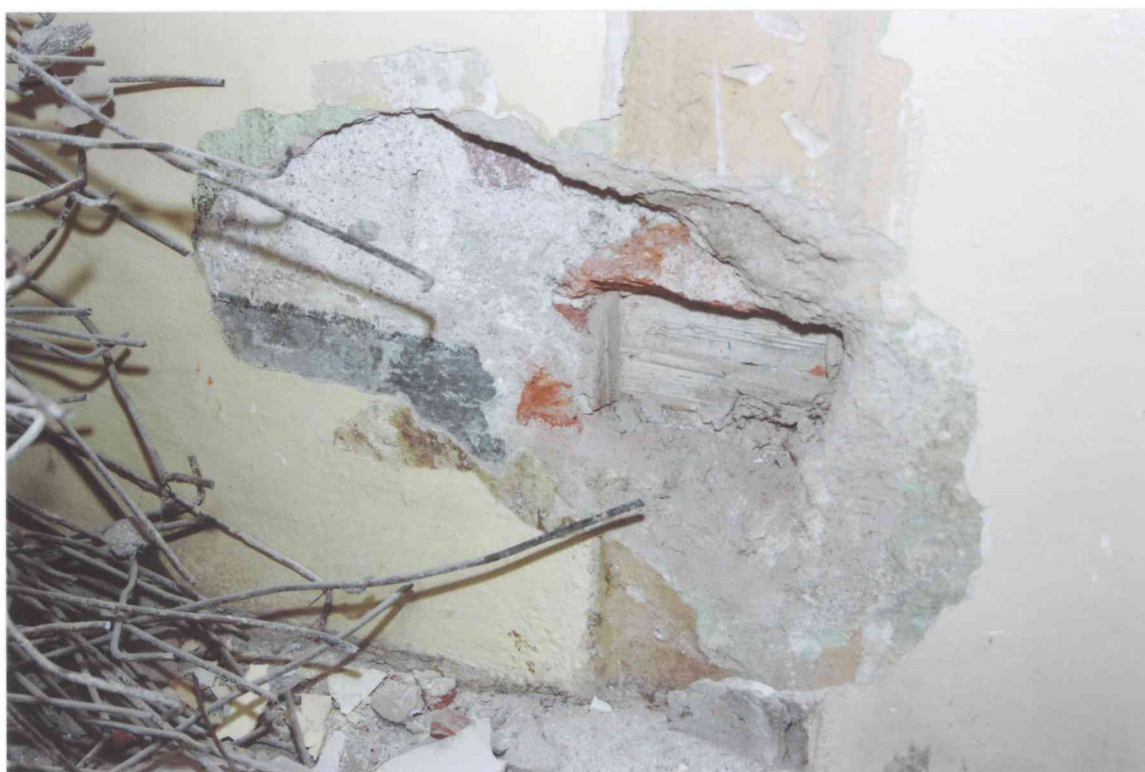
FOT. 8 - Pomieszczenie 0/15, ściana północna, detal fot. 2.
