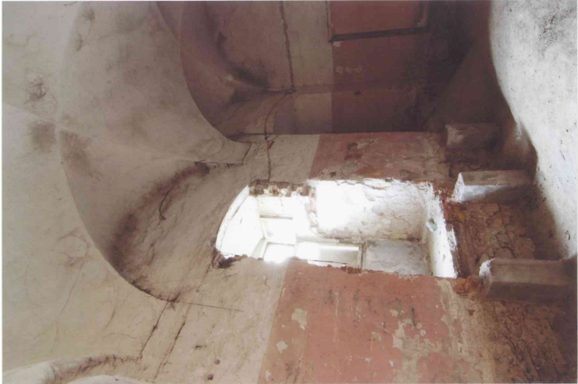
FOT. 5 - Pomieszczenie 0/20-K1, ściana wschodnia, detal fot. 3.
