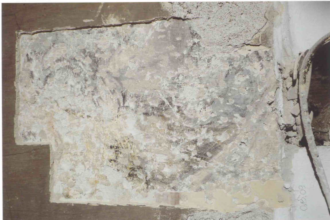
FOT. 10 - Pomieszczenie 0/13, ściana wschodnia, detal fot.3.
