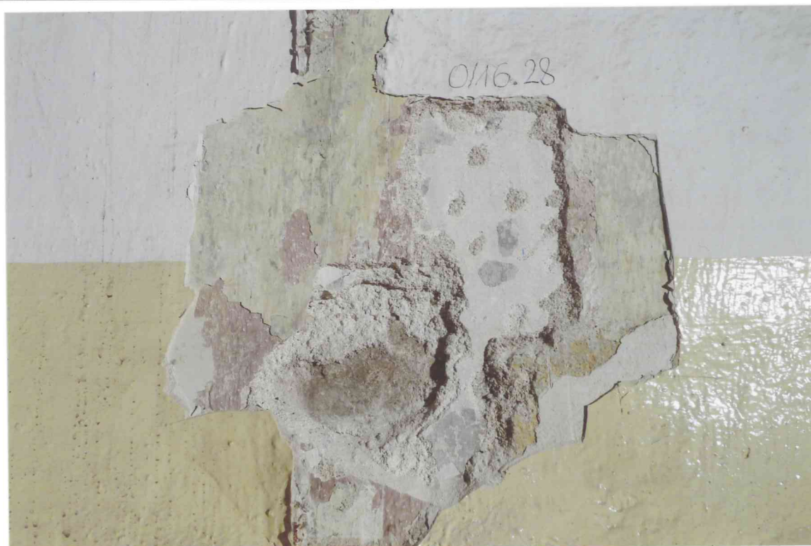
FOT. 28 - Pomieszczenie 0/16, ściana wschodnia, detal fot. 2.
