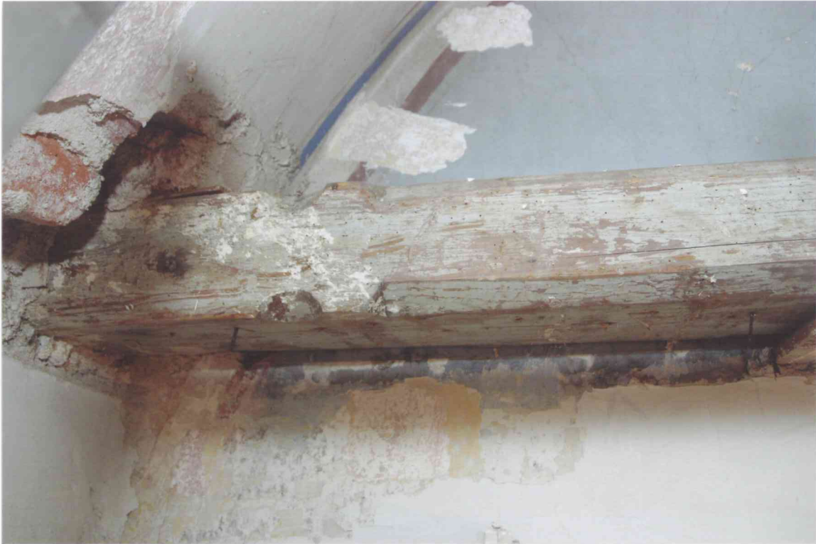
FOT. 7 - Pomieszczenie 0/12, detal fot. 5.
