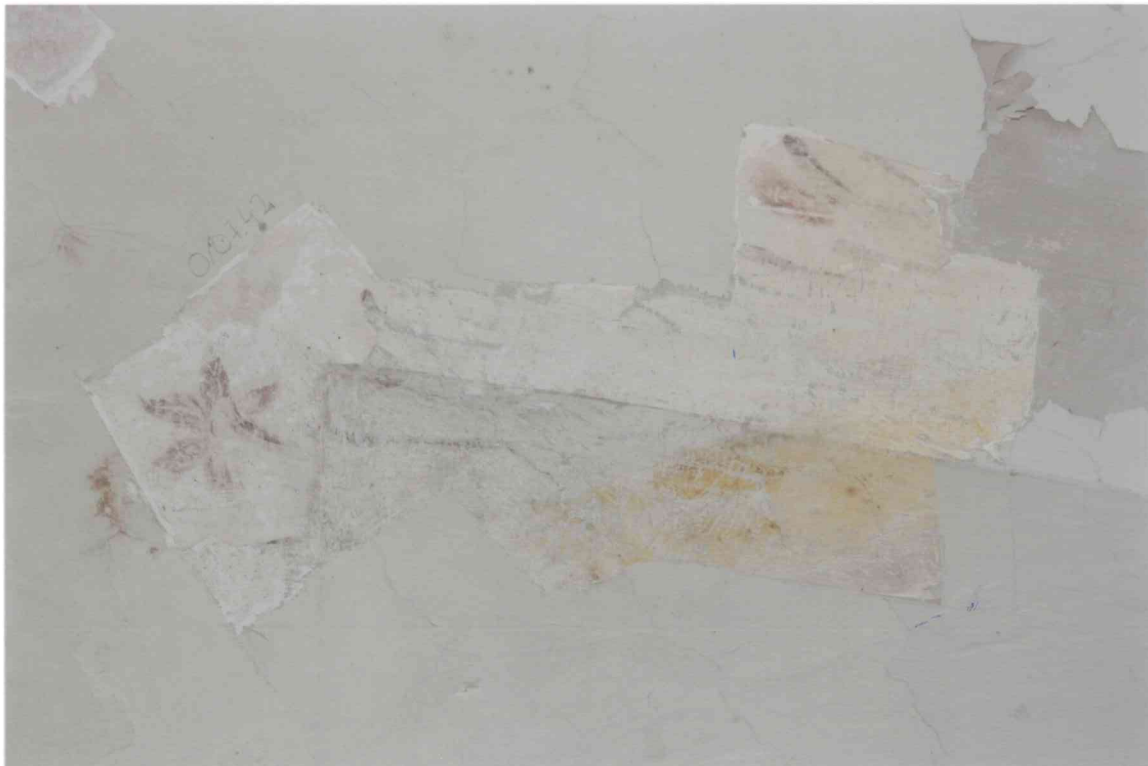
FOT. 14 - Pomieszczenie 0/07, detal fot. 6.
