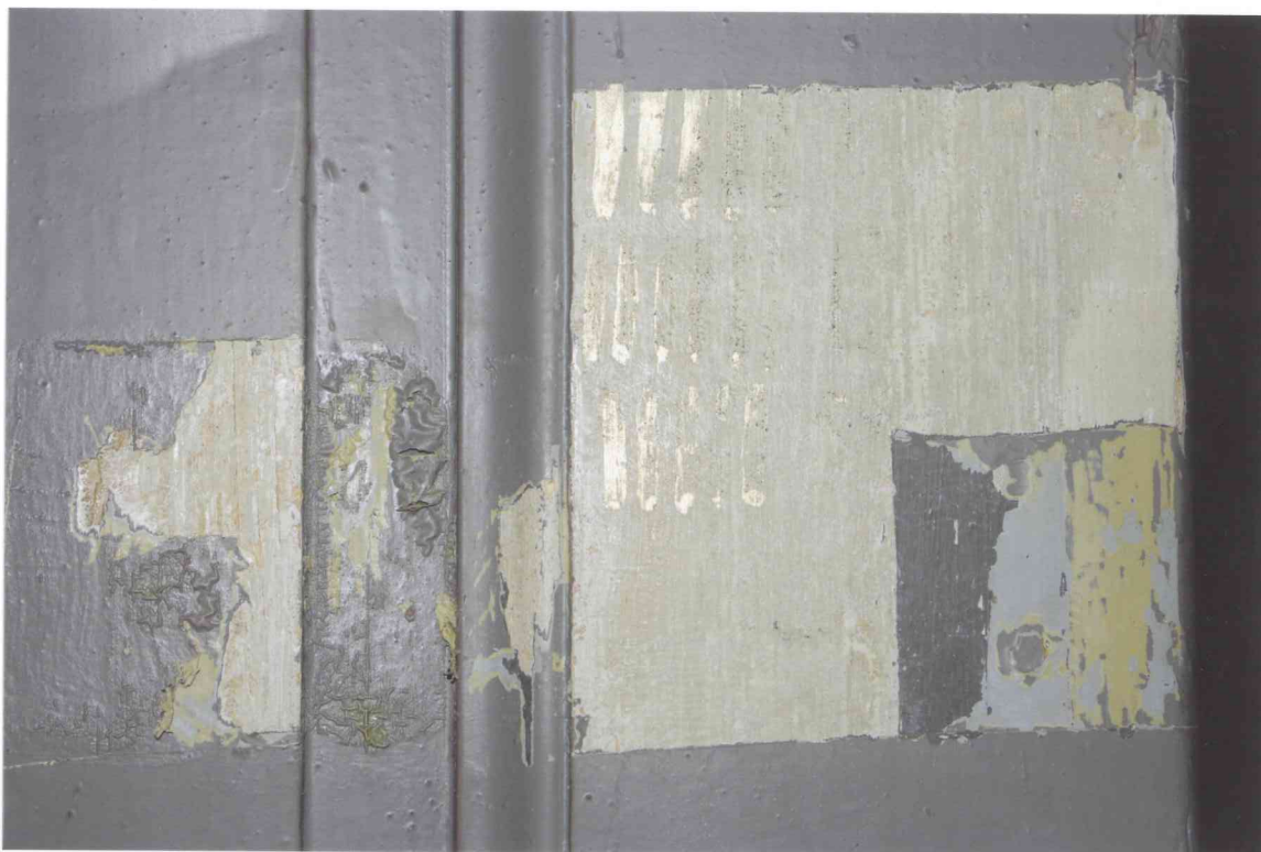
FOT. 25 - Pomieszczenie 0/07, drzwi wejściowe w ścianie południowej, ślady pozłoty.
