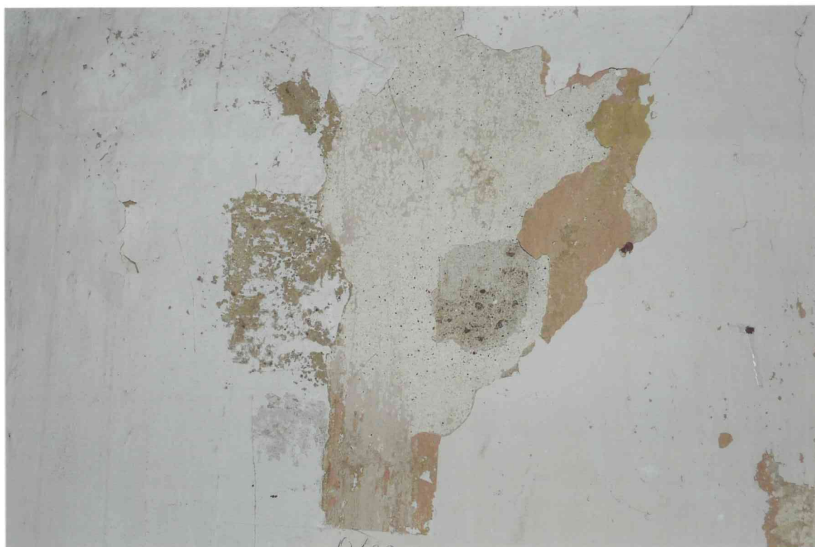
FOT. 3 - Pomieszczenie 0/08-0/09, ściana.
