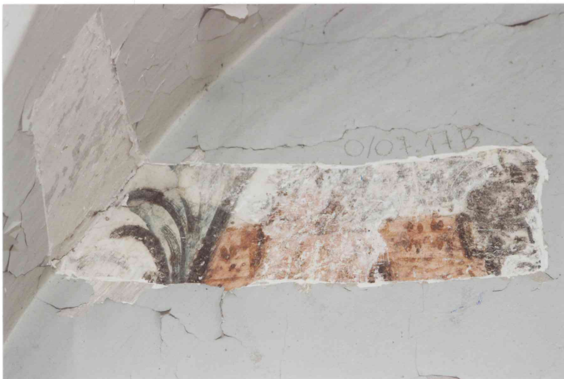
FOT. 20 - Pomieszczenie 0/07, detal fot. 19.
