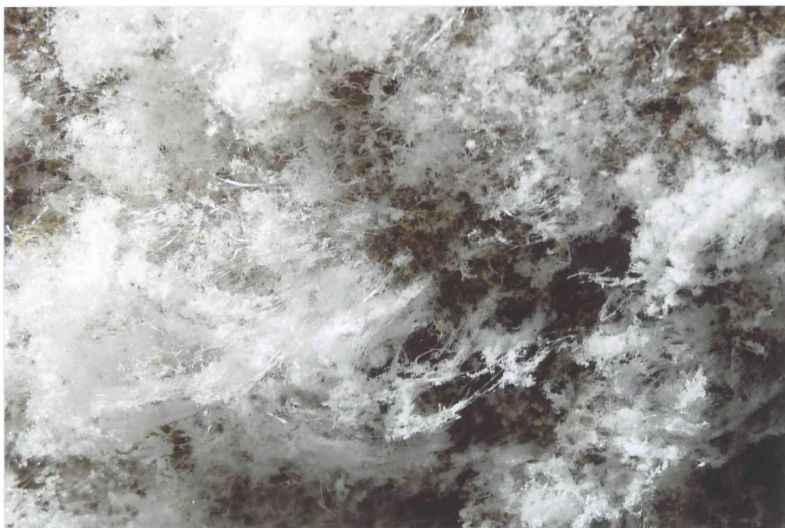
FOT. 4 - Pomieszczenie 0/08-0/09, ściana północna, wysolenia.
