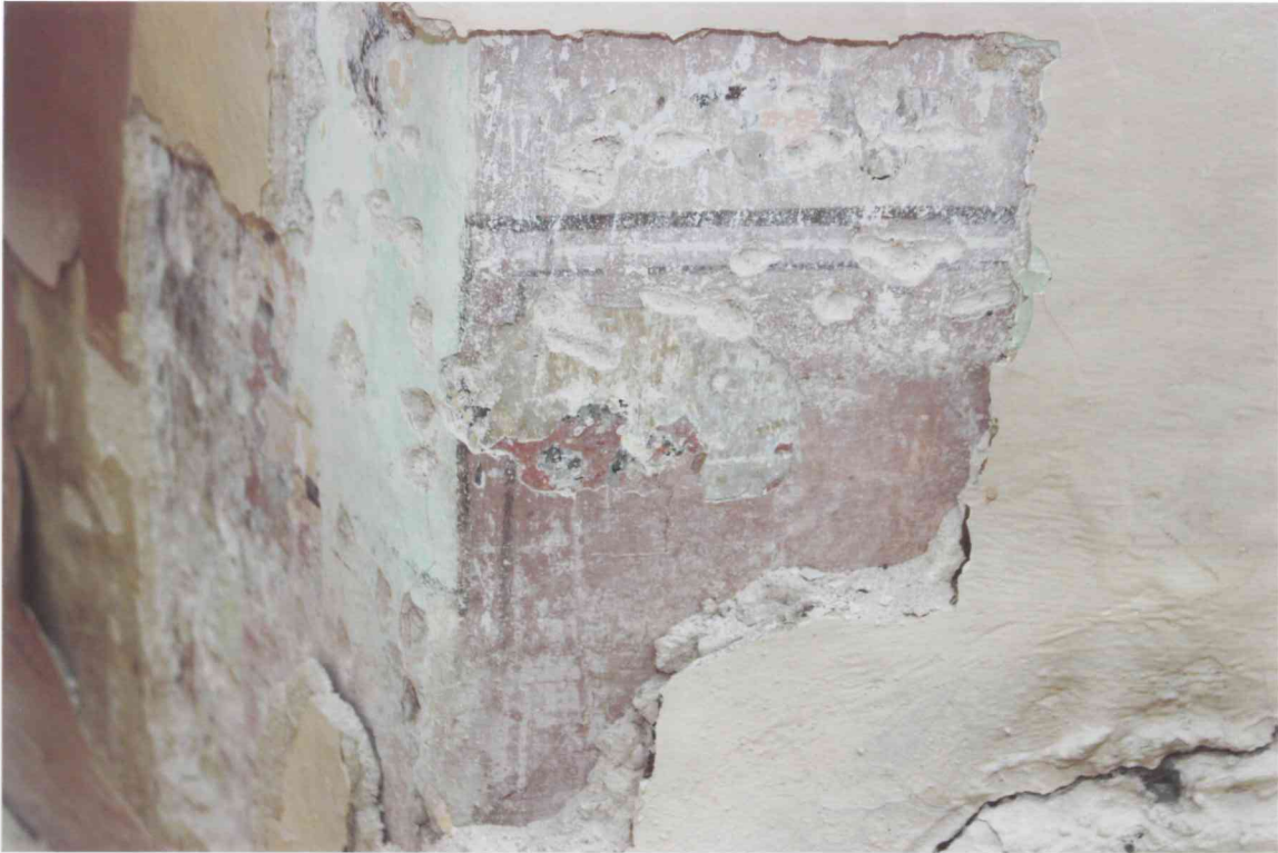
FOT. 7 - Pomieszczenie 0/11, gładz okienny, strefa cokołowa, detal fot. 5.
