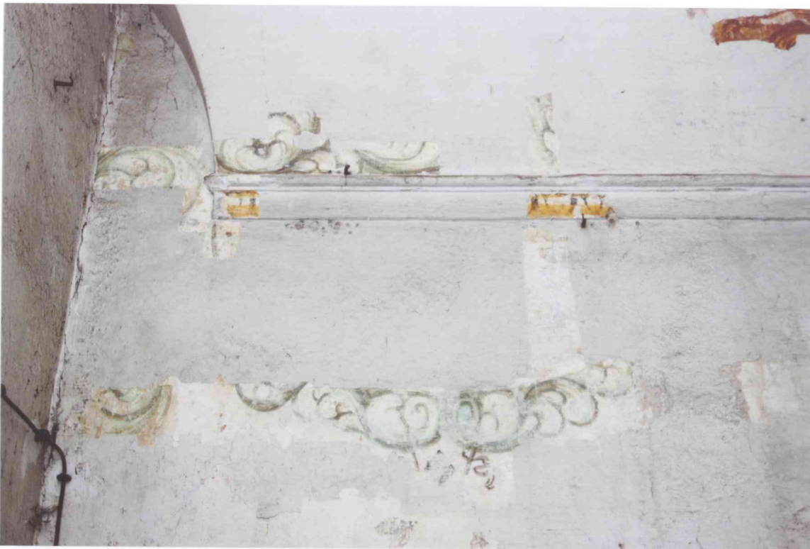
FOT. 31 - Pomieszczenie 0/2B, ściana wschodnia, detal fot. 24.
