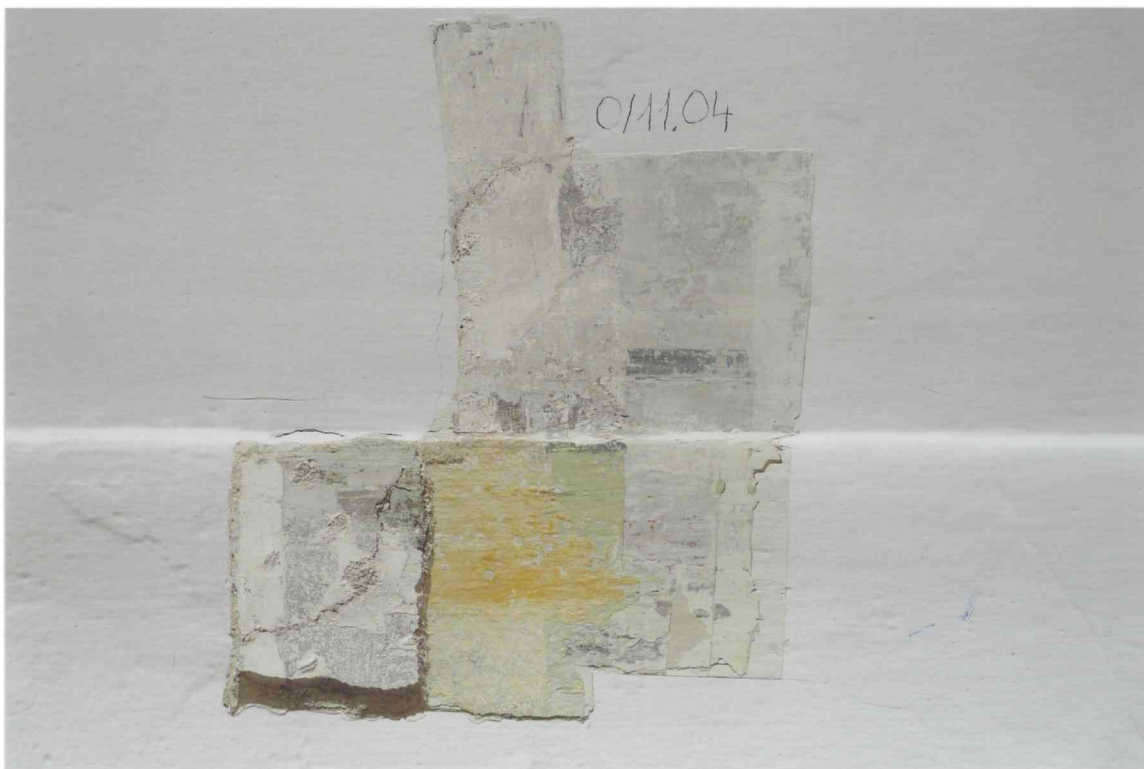
FOT. 10 - Pomieszczenie 0/11, ściana zachodnia, spływ sklepienia, detal fot. 1.
