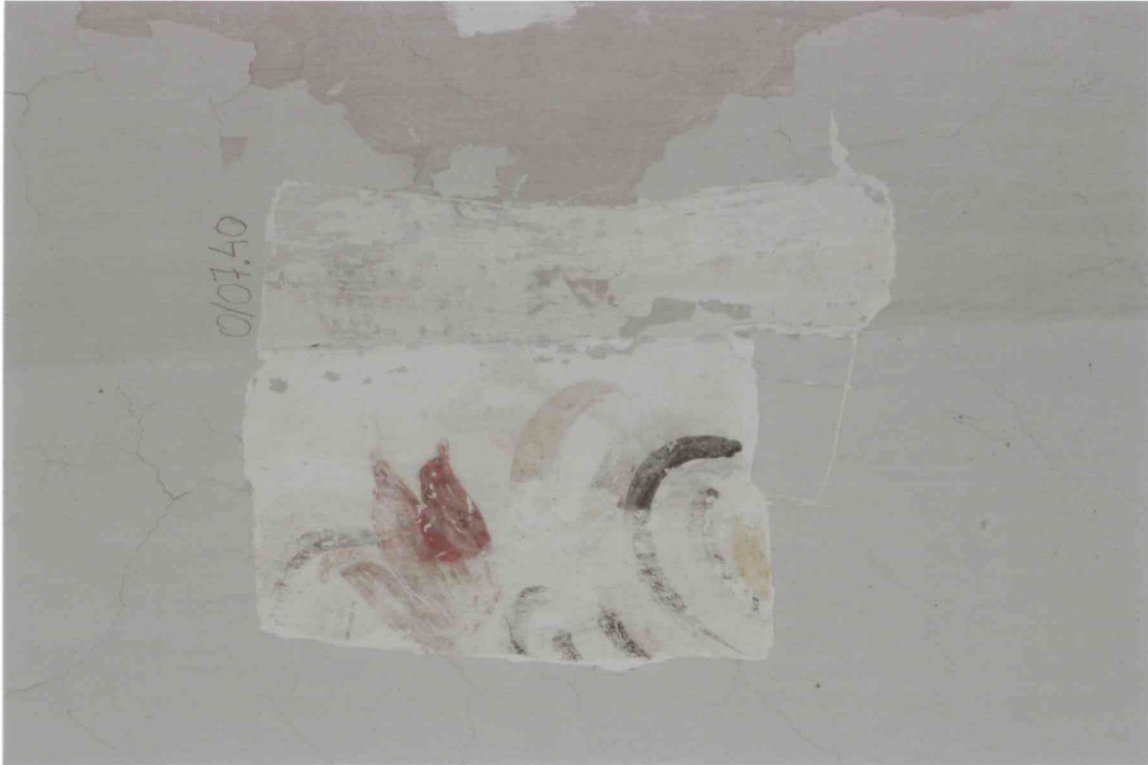
FOT. 13 - Pomieszczenie 0/07, sklepienie, detal fot.1.
