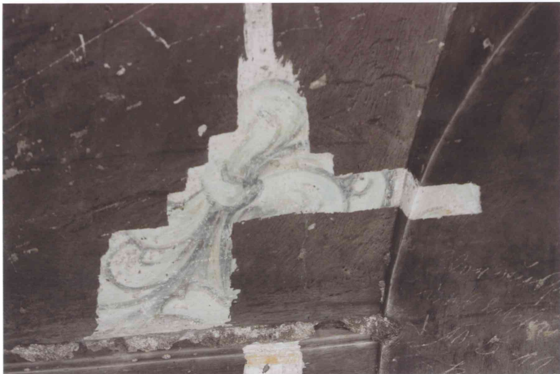
FOT. 18 – Pomieszczenie 0/2A, ściana wschodnia, detal fot.3.
