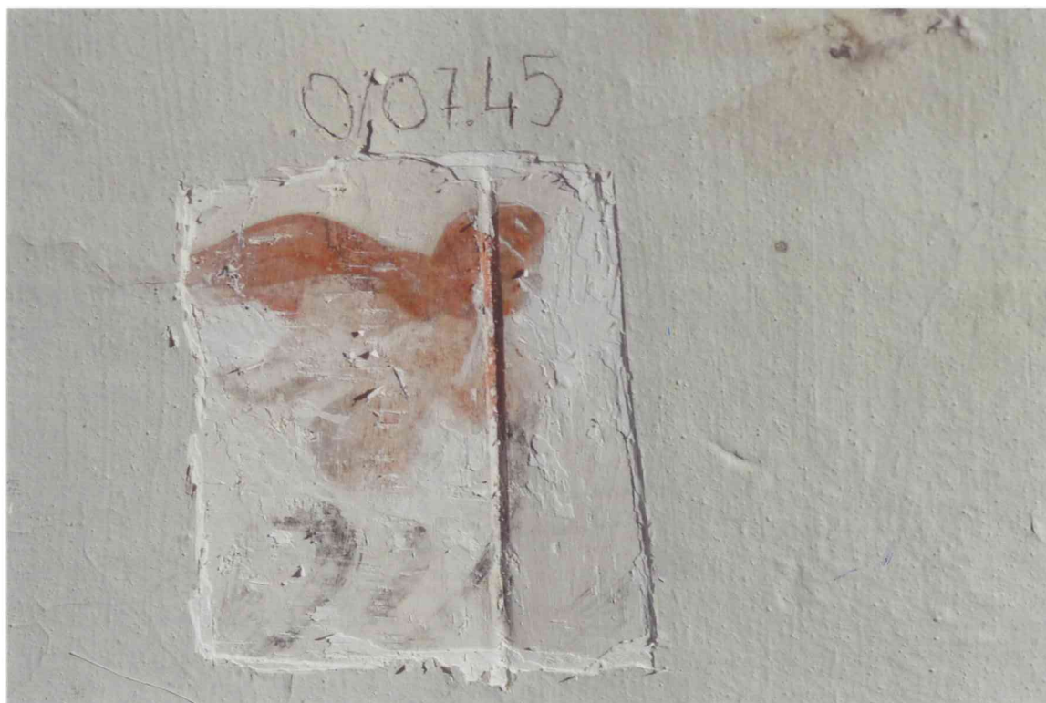
FOT. 12 - Pomieszczenie 0/07, detal fot. 11.
