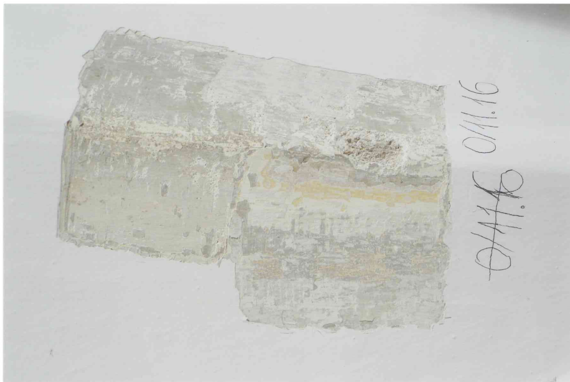
FOT. 13 - Pomieszczenie 0/11, sklepienie, detal fot.3.
