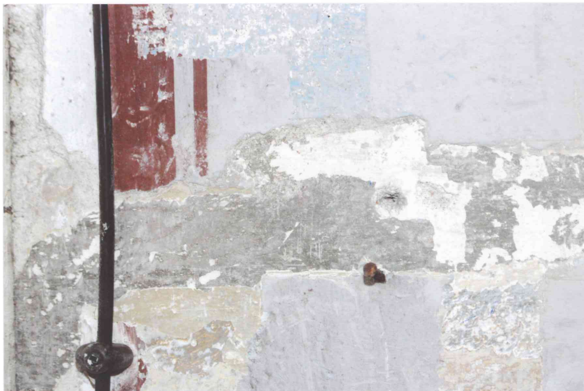
FOT. 6 - Pomieszczenie 0/A, ściana wschodnia, detal fot.2.
