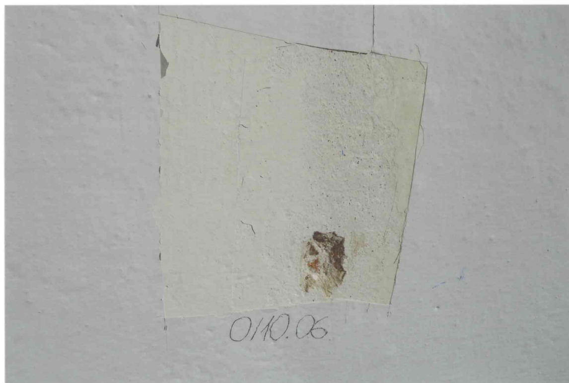
FOT. 6 - Pomieszczenie 0/10, sklepienie, detal fot.2.
