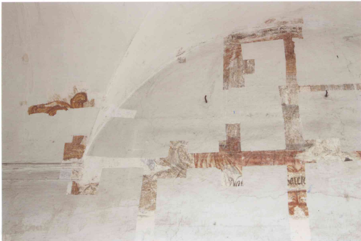
FOT. 28 – Pomieszczenie 0/2B, ściana wschodnia, detal fot. 25.
