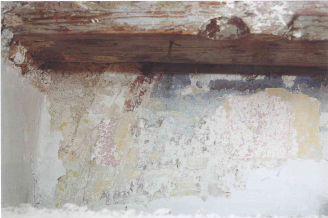
FOT. 8 - Pomieszczenie 0/12, detal fot. 7.
