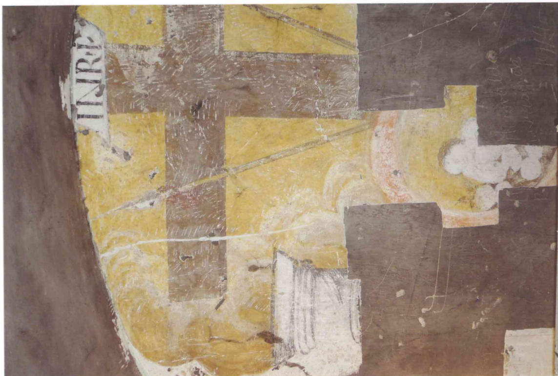
FOT. 14 – Pomieszczenie 0/2A, ściana wschodnia, detal fot.3
