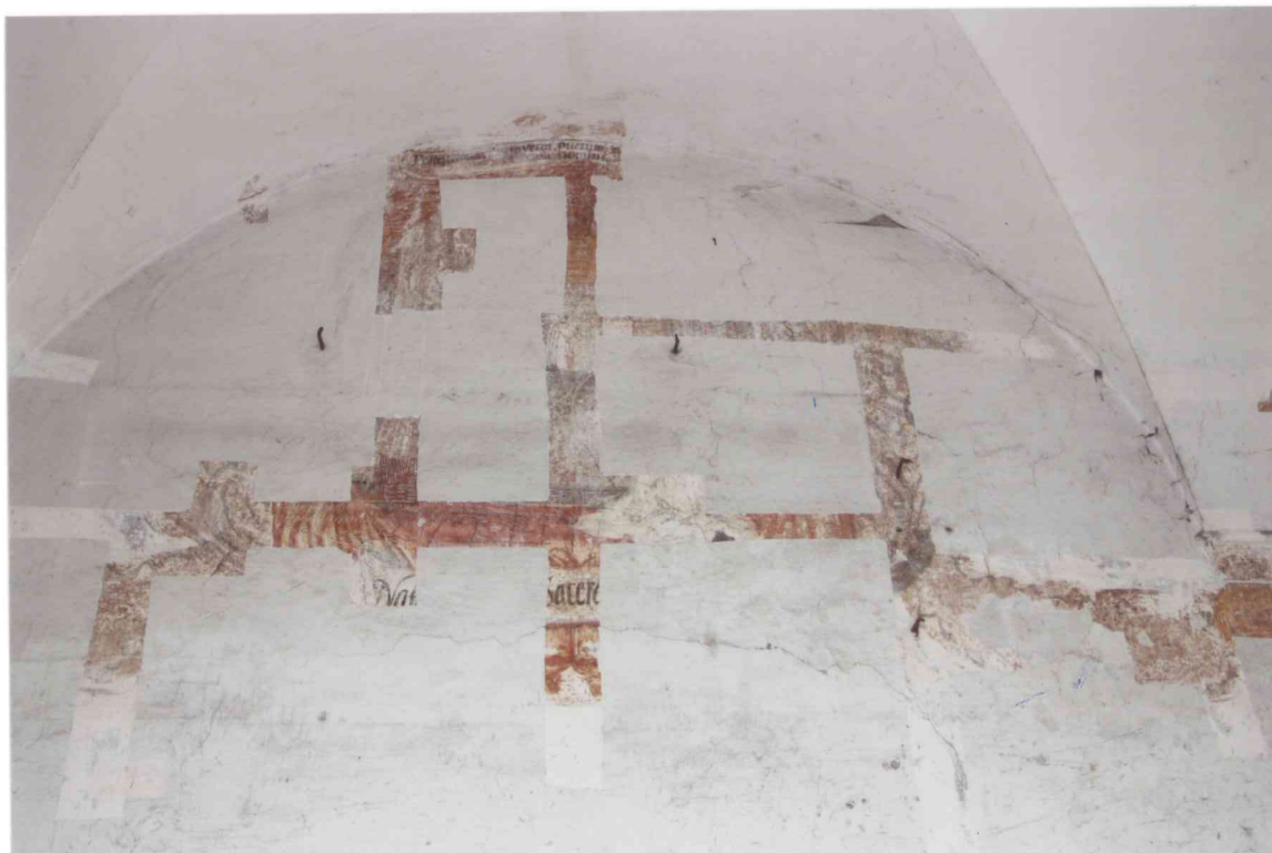
FOT. 26 – Pomieszczenie 0/2B, ściana wschodnia, detal fot. 23.
