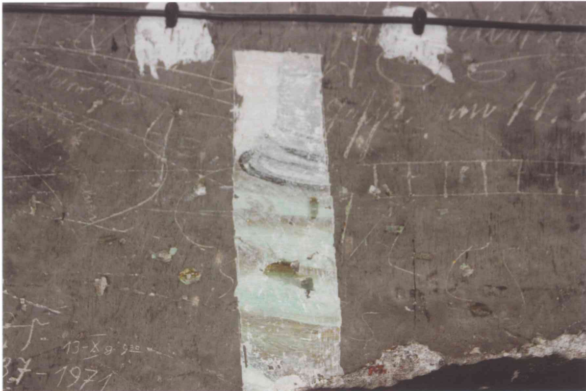
FOT. 17 – Pomieszczenie 0/2A, ściana wschodnia, detal fot.3.
