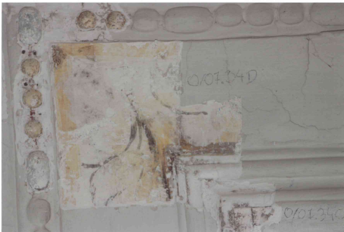
FOT. 8 - Pomieszczenie 0/07, detal fot. 5.
