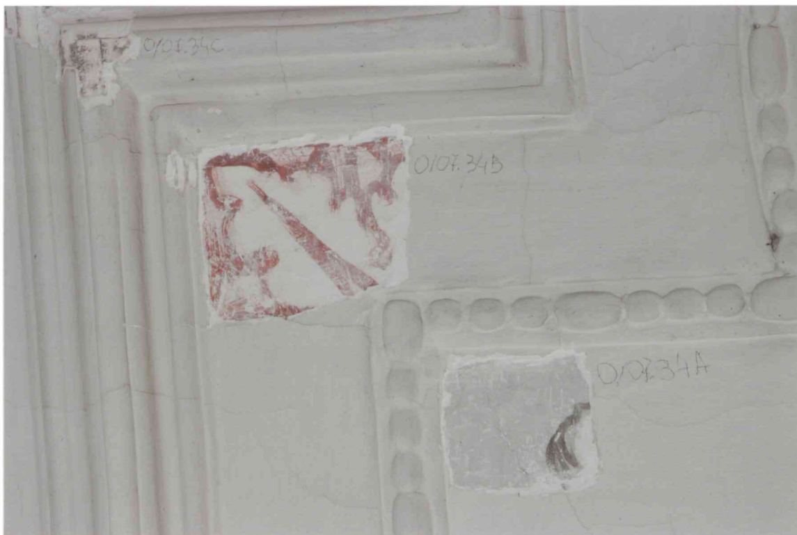
FOT. 9 - Pomieszczenie 0/07, detal fot. 5.
