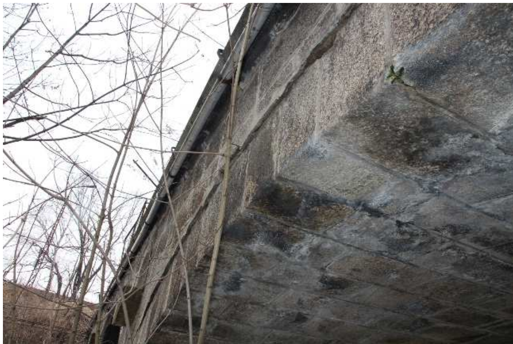
Fot. 6.2 Odspojenie i przesunięcie na 4 cm ściany czołowej północnej nad przęsłem S1 wraz z odchyleniem od pionu na 3 cm.
