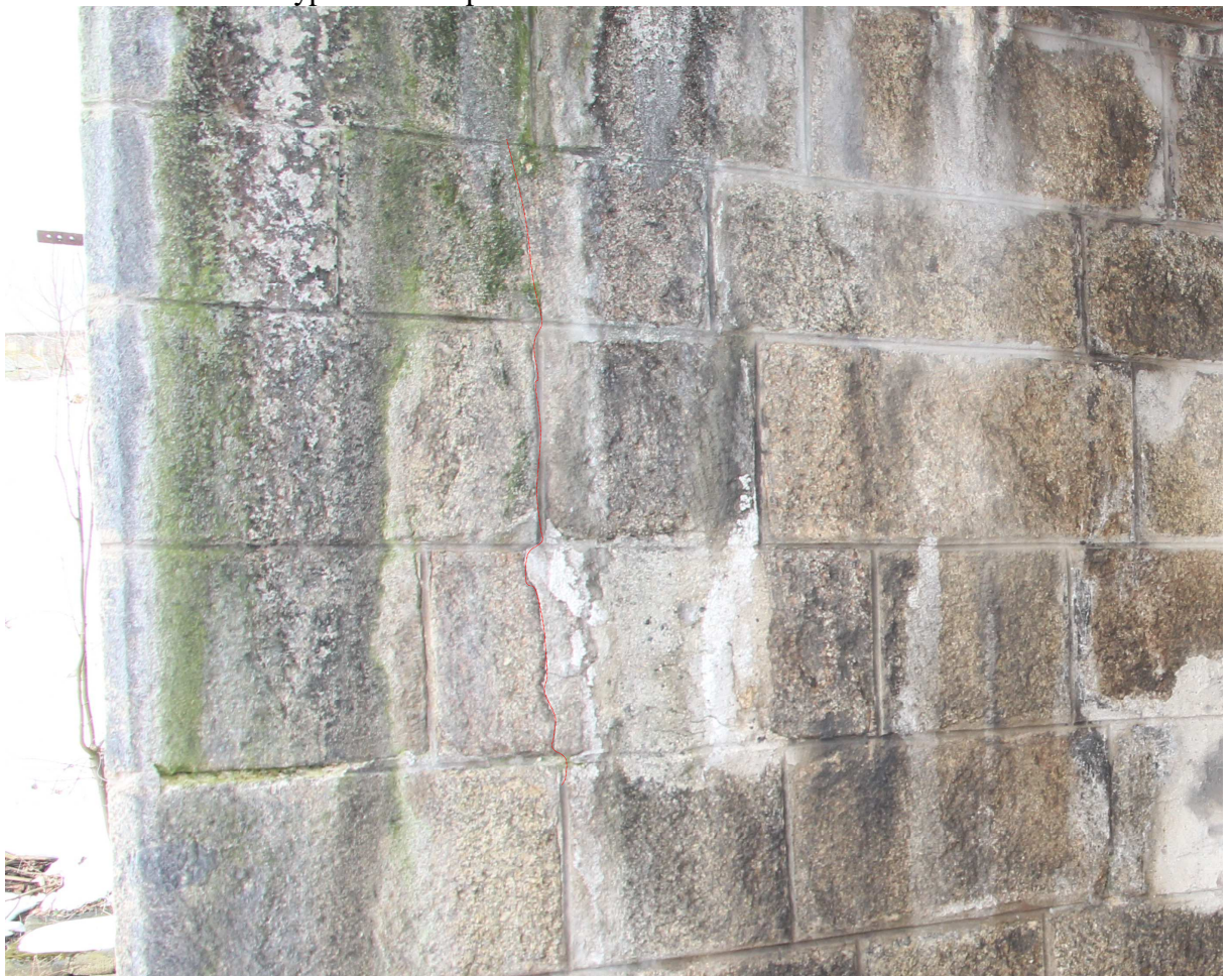
Fot. 6.2 2 Pęknięcie ciosów kamiennych na podporze P3 nad sklepieniem S3.
