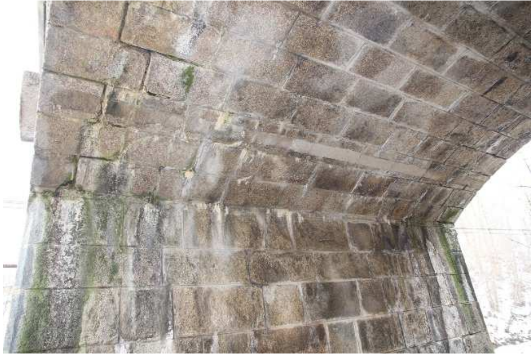
Fot. 6.2 2 Zarysowania, zawilgocenia, zacieki i wykwyty na podporze P3 i sklepieniu S3 wraz z wypłukaniem spoin.
