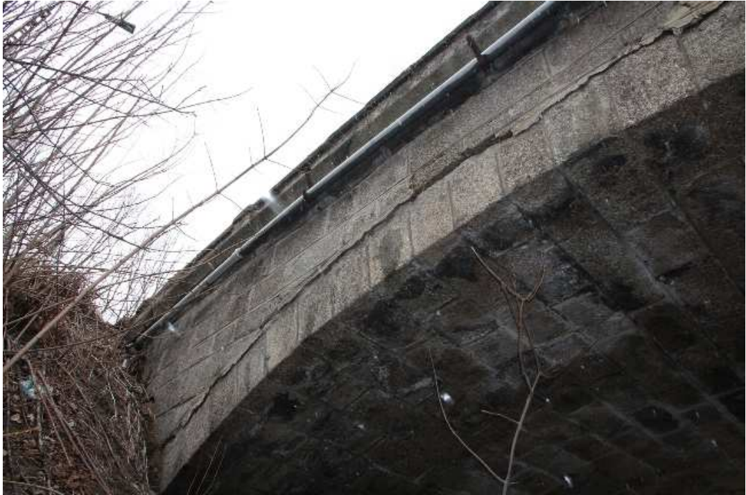
Fot. 6.2 2 Odspojenie i przesunięcie na 6 cm ściany czołowej północnej nad przęśtem S3.
