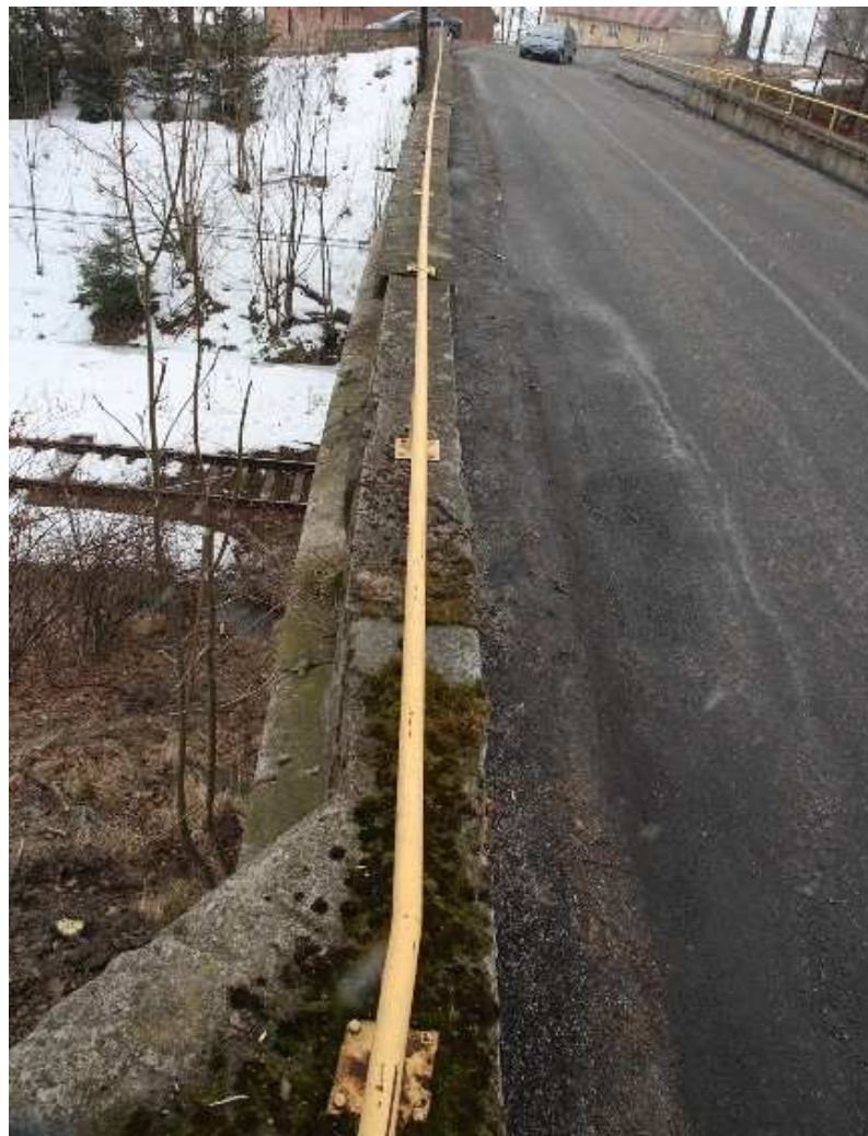
Fot. 6.1 Zakrzywienie i odchylenie muru południowego nad przęsłem S3
