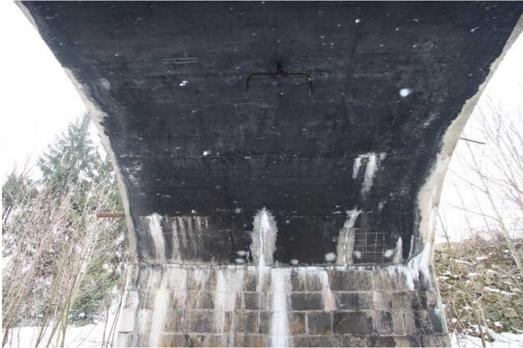
Fot. 6.2 2 Zarysowania, zawilgocenia, zacieki i wykwyty na sklepieniu betonowym S2 i podporze P2.
