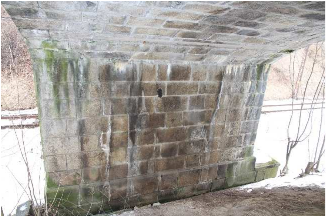
Fot. 6.2 2 Zawilgocenia, zacieki i wykwyty na podporze P2 i sklepieniu S1.
