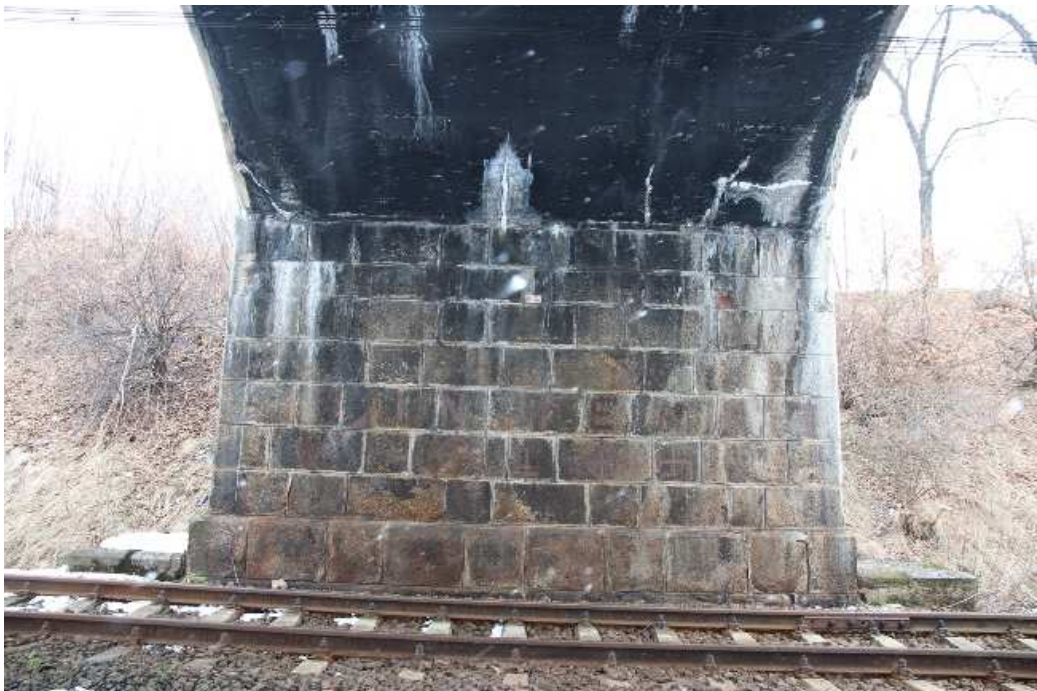
Fot. 6.2 2 Zarysowania, zawilgocenia, zacieki i wykwyty na podporze P3 i sklepieniu betonowym S2.
