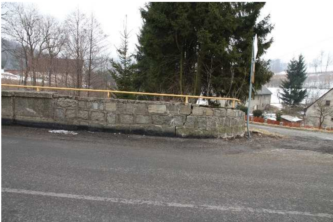
Fot. 6.1 Pęknięcie murku południowego od strony Rybnicy
