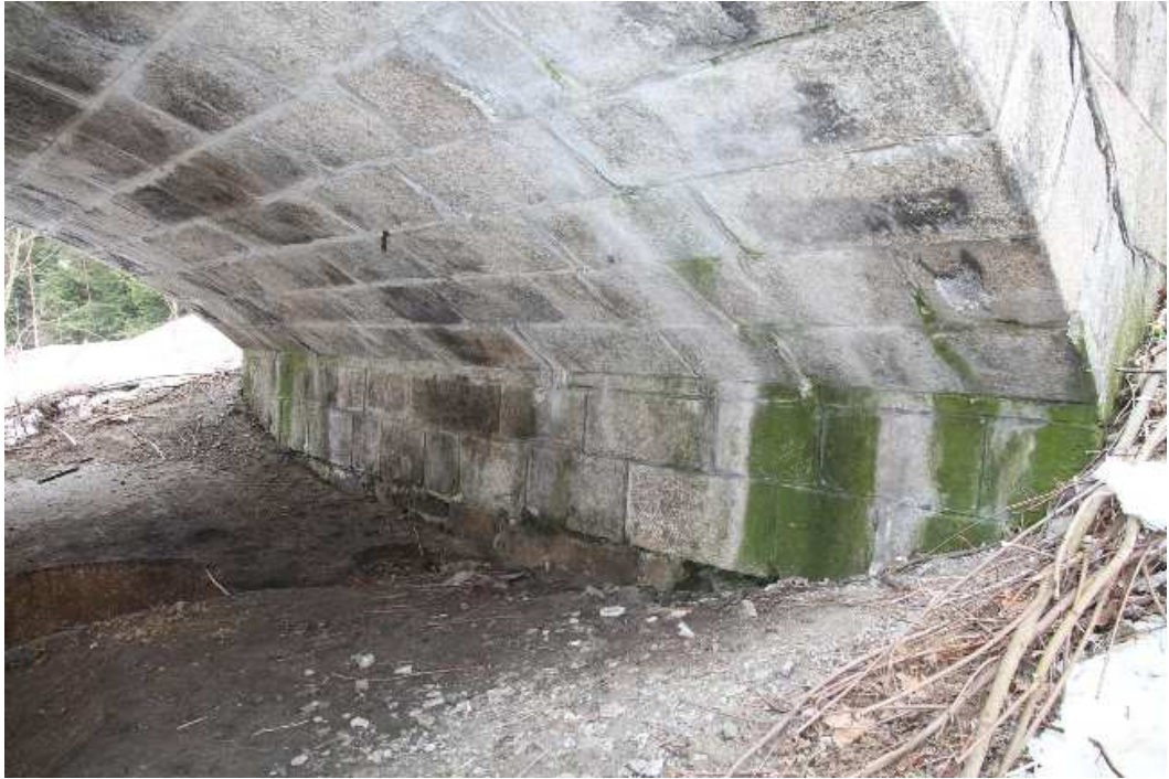
Fot. 6.2 2 Zawilgocenia, zacieki i wykwyty na podporze P1 i sklepieniu S1 wraz z podmyciem skarpy.
