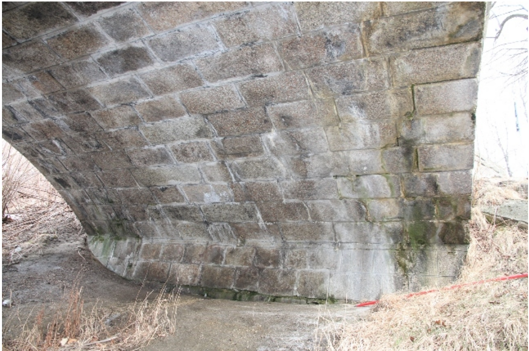
Fot. 6.2 2 Zarysowania, zawilgocenia, zacieki i wykwyty na podporze P4 i sklepieniu S3
