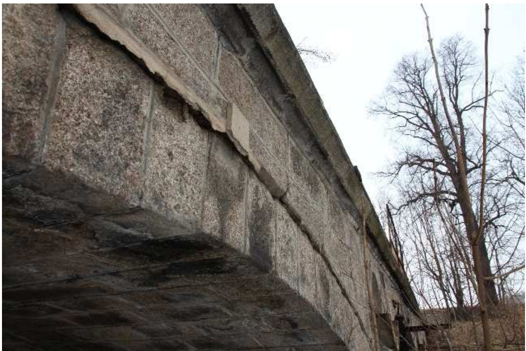
Fot. 6.2 Odspojenie i przesunięcie na 6 cm ściany czołowej południowej nad przęsłem S1 wraz z odchyleniem od pionu na 3 cm.
