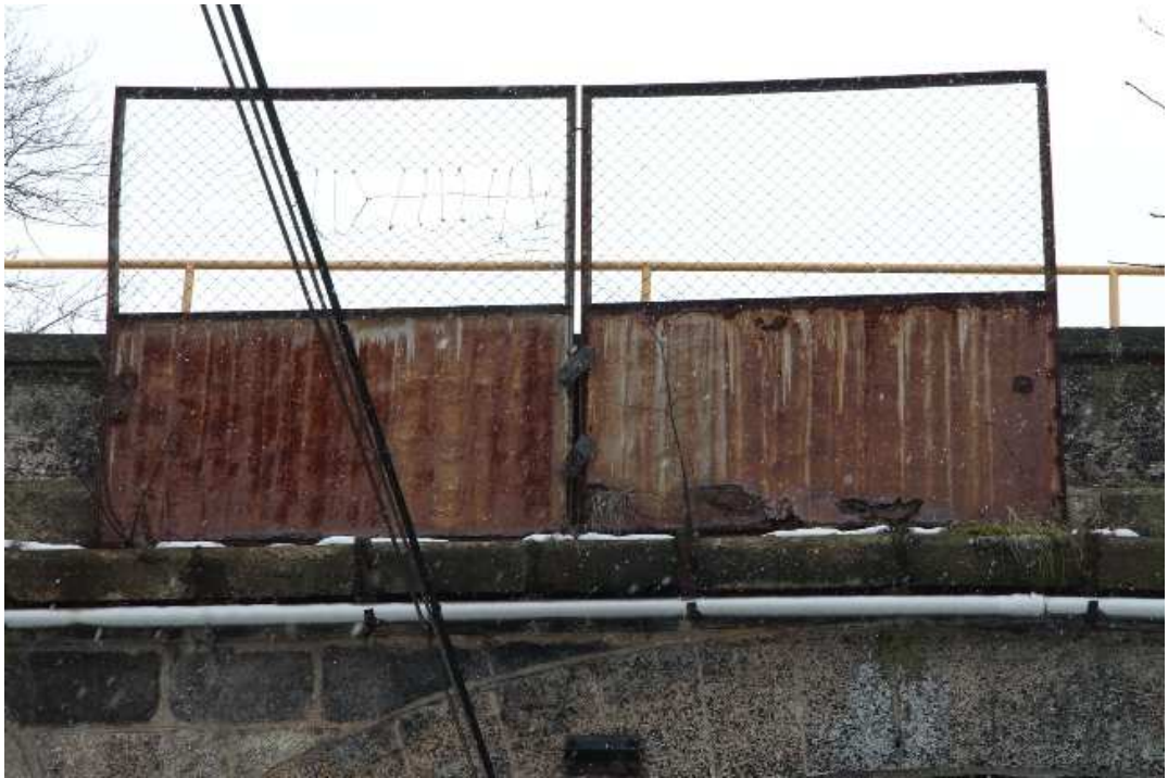
Fot. 6.1 Korozja, ubytki i uszkodzenia ekranów przeciwporażeniowych od północy
