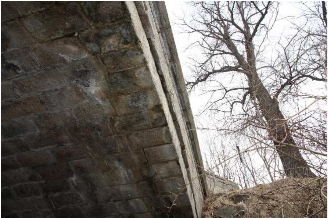
Fot. 6.2 2 Odspojenie i przesunięcie na 10 cm ściany czołowej południowej nad przęśtem S3.
