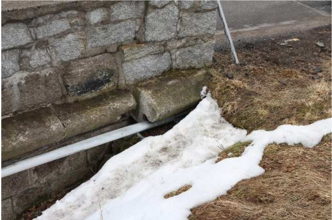
Fot. 6.2 Odspojenie i przesunięcie gzymsu murku północnego od strony Rybnicy.
