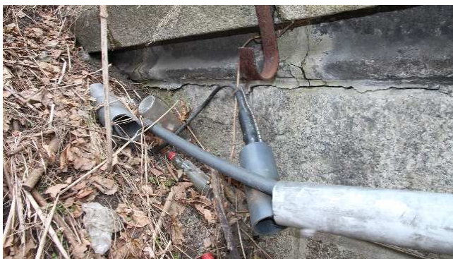
Fot. 6.2 Uszkodzenie osłony kabla od strony północnej w kierunku Jeleniej Góry.
